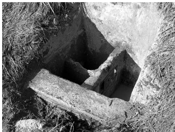
Ph. 17c. La mise à jour de l'ancien diviseur montre une vanne à guillotine encore parfaitement fonctionnelle (qui pouvait se fermer ou réguler la sortie vers l'ancien lavoir, si besoin) !
