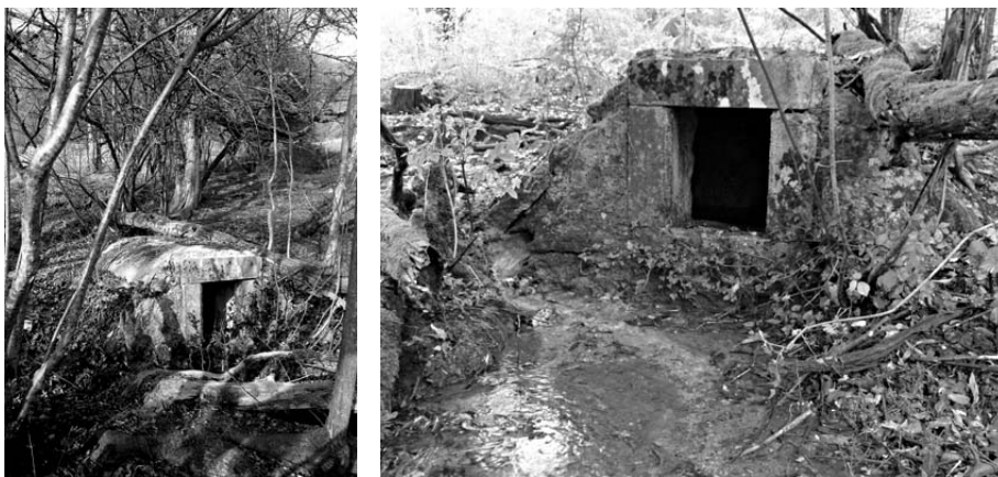
Ph. 52 a et 52b. Ancienne source captée ou tabouret de Conjocle, après de fortes pluies, l'eau sort abondamment en bas à gauche de l'ancienne porte...
